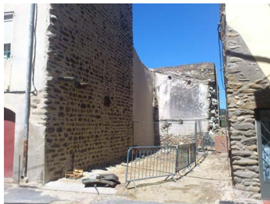
Rue de la Nyanya, où une maison s'est récemment effondrée.
